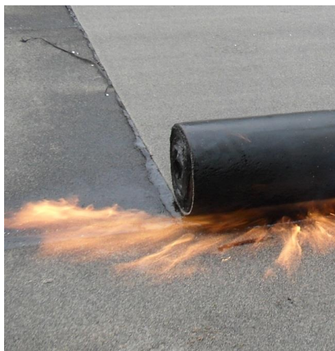
Рисунок 13 – Вытекание расплавленного битумного вяжущего из-под боковой кромки материала
